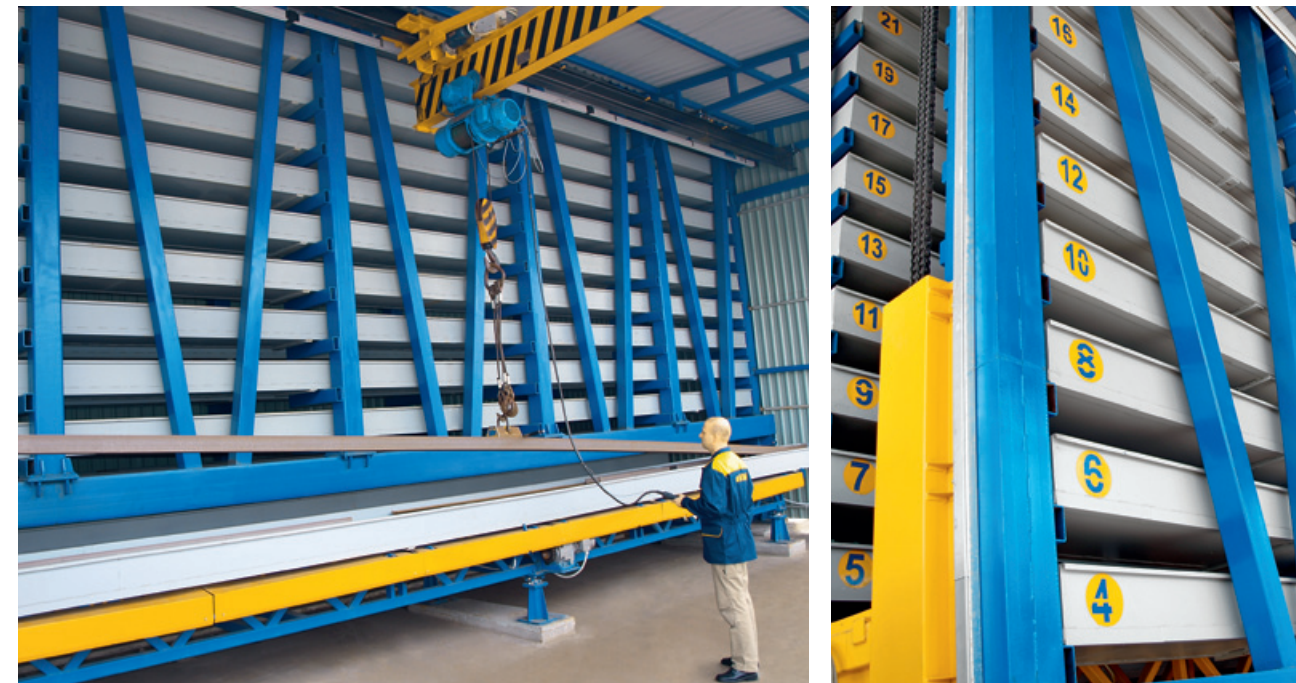
Автоматизированный склад профильного металлопроката
