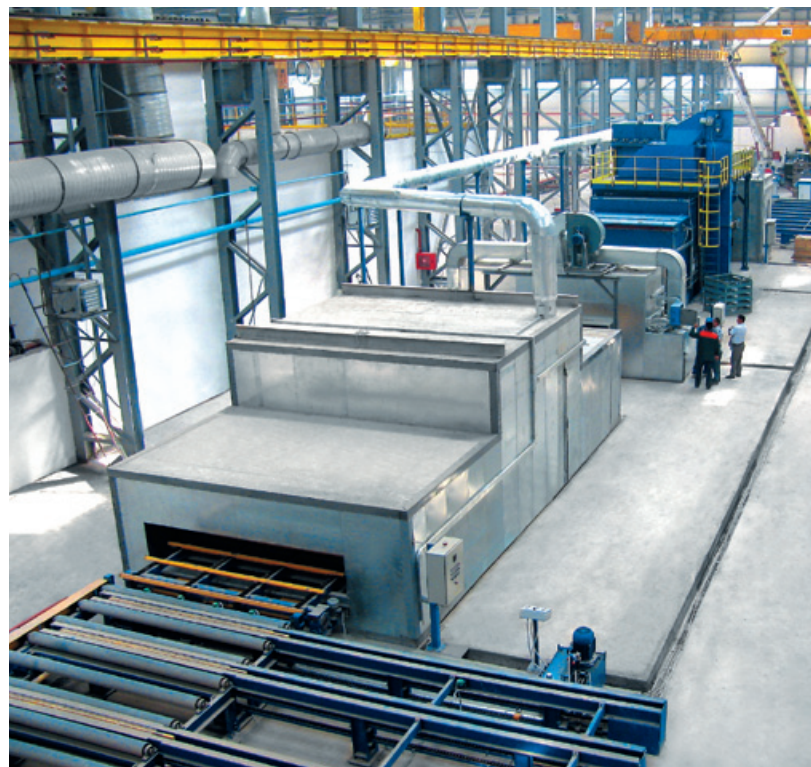
Линия очистки и консервации металлопроката
