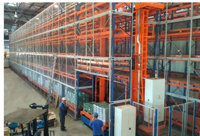
Автоматизированный склад стеллажного типа
