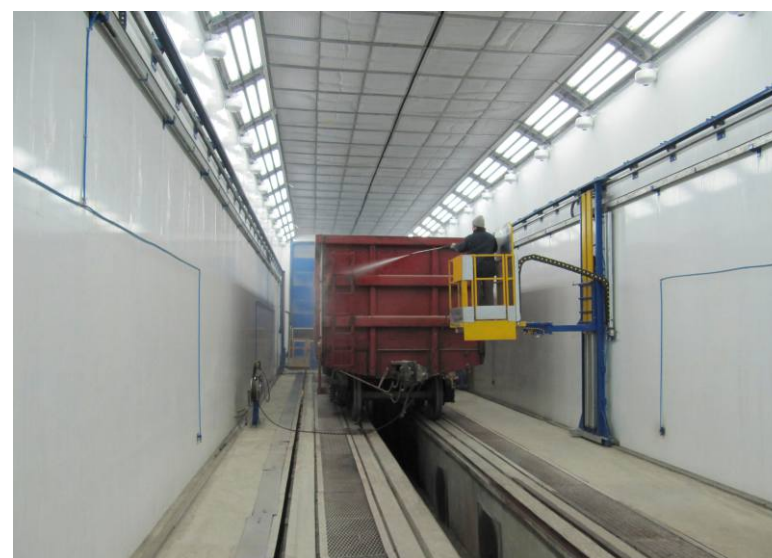
Окрасочно-сушильная камера (с функцией обезжиривания)
