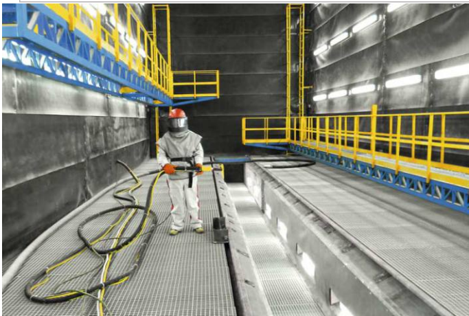
Дробеструйная камера с подъемными платформами
