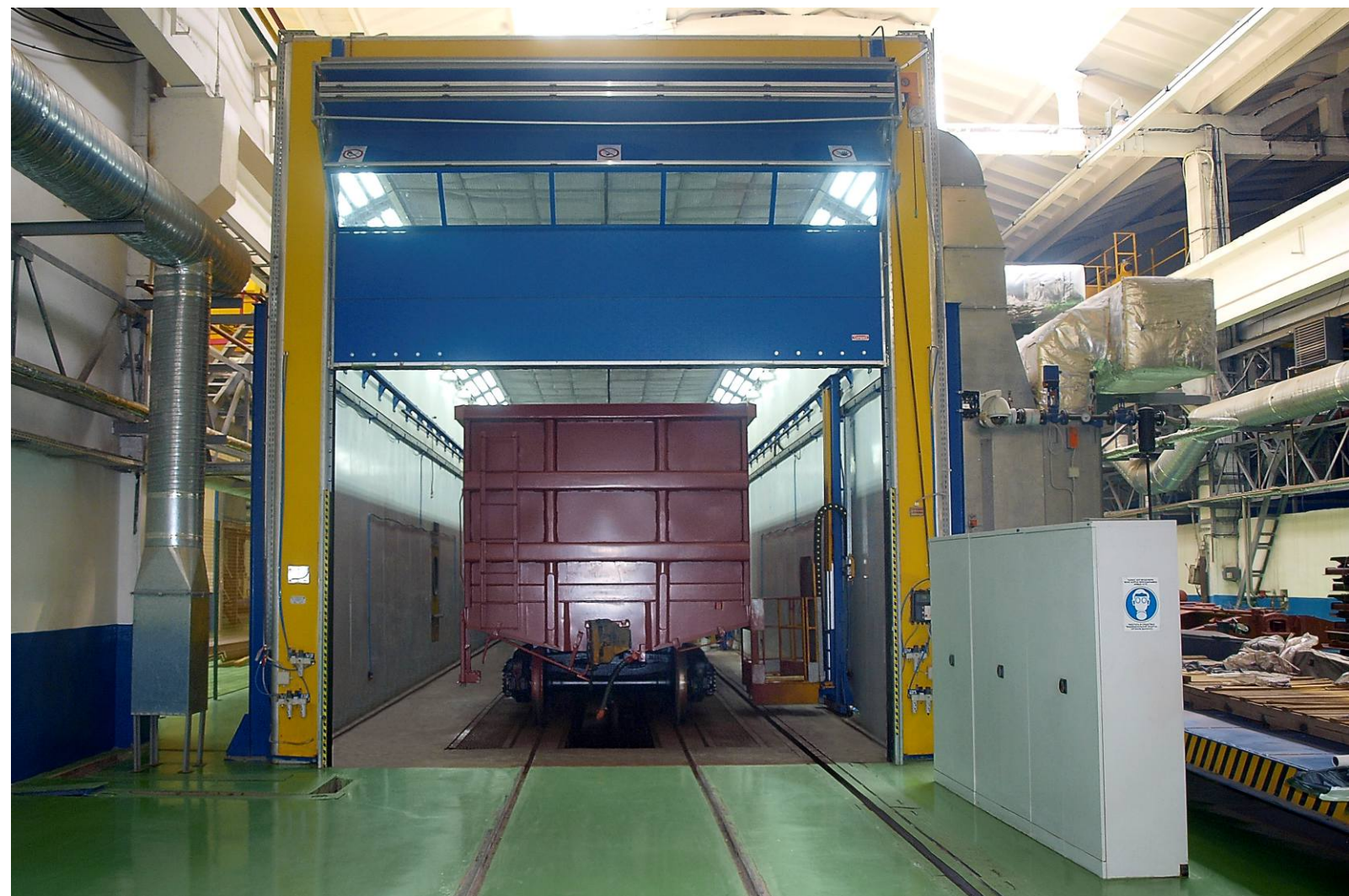
Окрасочно-сушильная камера для вагонов
