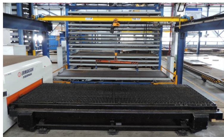
Автоматизований склад листового металопрокату
